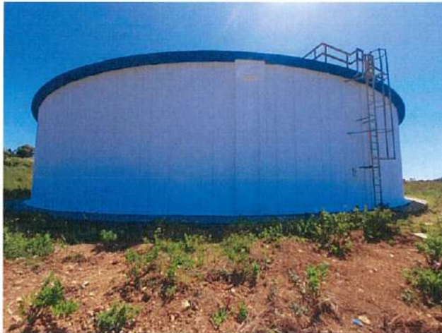
RESERVATÓRIO ALTA NOVA MAFRA
